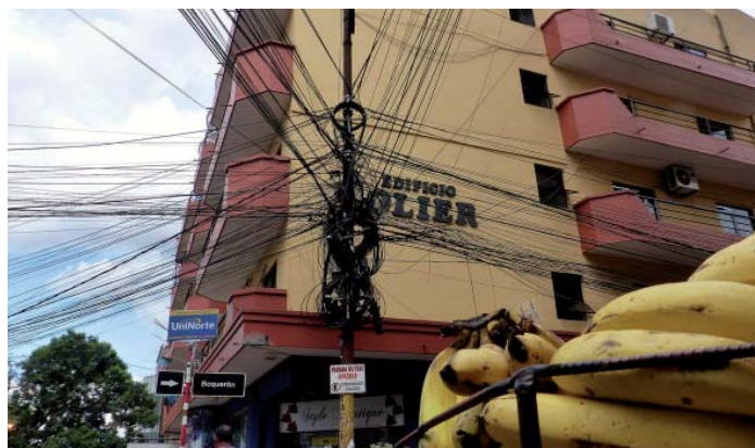
11 - l'enfouissement des fils électriques n'est pas au programme
